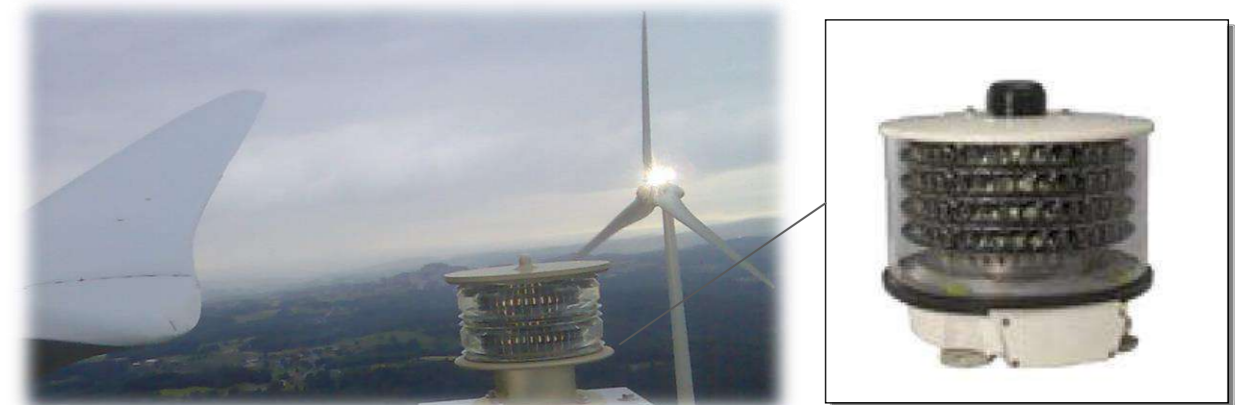
Figure 41 : Balisage d'une éolienne.
