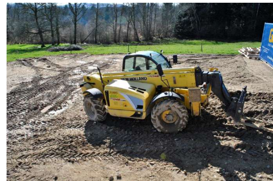
Photographie 38 : Exemple de tassement et d'ornières créés par les engins de chantier
